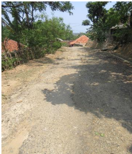
Gambar 5.4. Kondisi jalan poros tengah yang rusak berat
