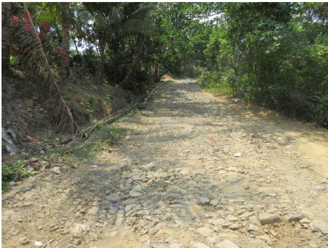
Gambar 5.2. Kondisi jalan poros tengah yang tidak rata dan penuh lubang
