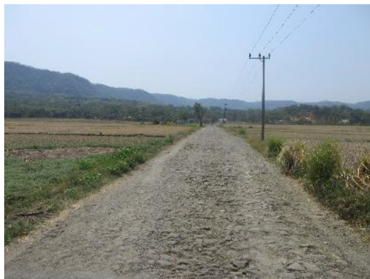
Gambar 4.12 Kerusakan pada Jalan Poros Tengah di Kawasan Citamansakti
