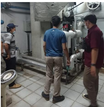
Gambar 17. Peninjauan Instalasi Inverter
